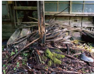
管理職が住んでいた社宅 軒下の柱が腐食 RZ67 II 65mm F16 1/60 秒 RDP III
